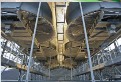
Hava Soğutmalı Isı Değiştirici Air Cooled Heat Exchanger
